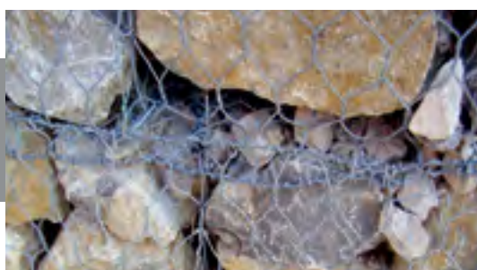
» Príklad nekvalitne vyloženého čela gabionu. Kamenivo v čele je príliš drobné a medzerovitost' veľká.
